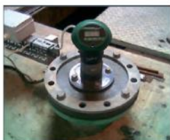
УРОВНЕМЕР IMP НА РЕЗЕРВУАРЕ С РАСТВОРОМ БЕЛИЛЬНОЙ ИЗВЕСТИ
