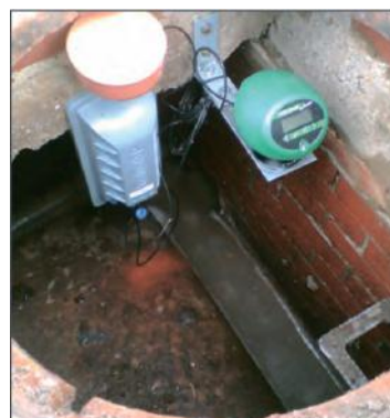
УРОВНЕМЕР IMP, ОСУЩЕСТВЛЯЮЩИЙ ТЕКУЩИЙ КОНТРОЛЬ В КАМЕРЕ ОБЩЕСПЛАВНОЙ КАНАЛИЗАЦИИ
